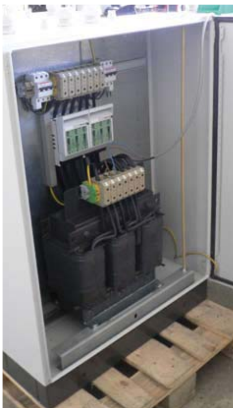
Versorgungseinheit mit integrierter Absicherung
