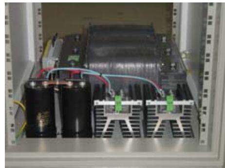
Hochstrom DC-Versorgung im Schrankgehäuse
