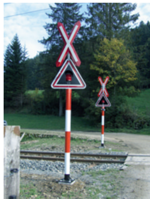
Blinklichtsignal mit Blitzleuchte, montiert auf vorfabriziertes Betonfundament.
