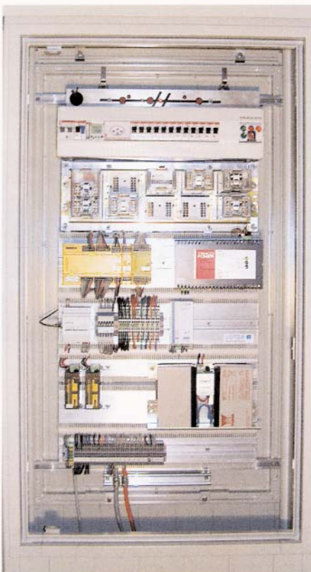
Bild 3: Steuerung in Doppelwand-Alukabine
