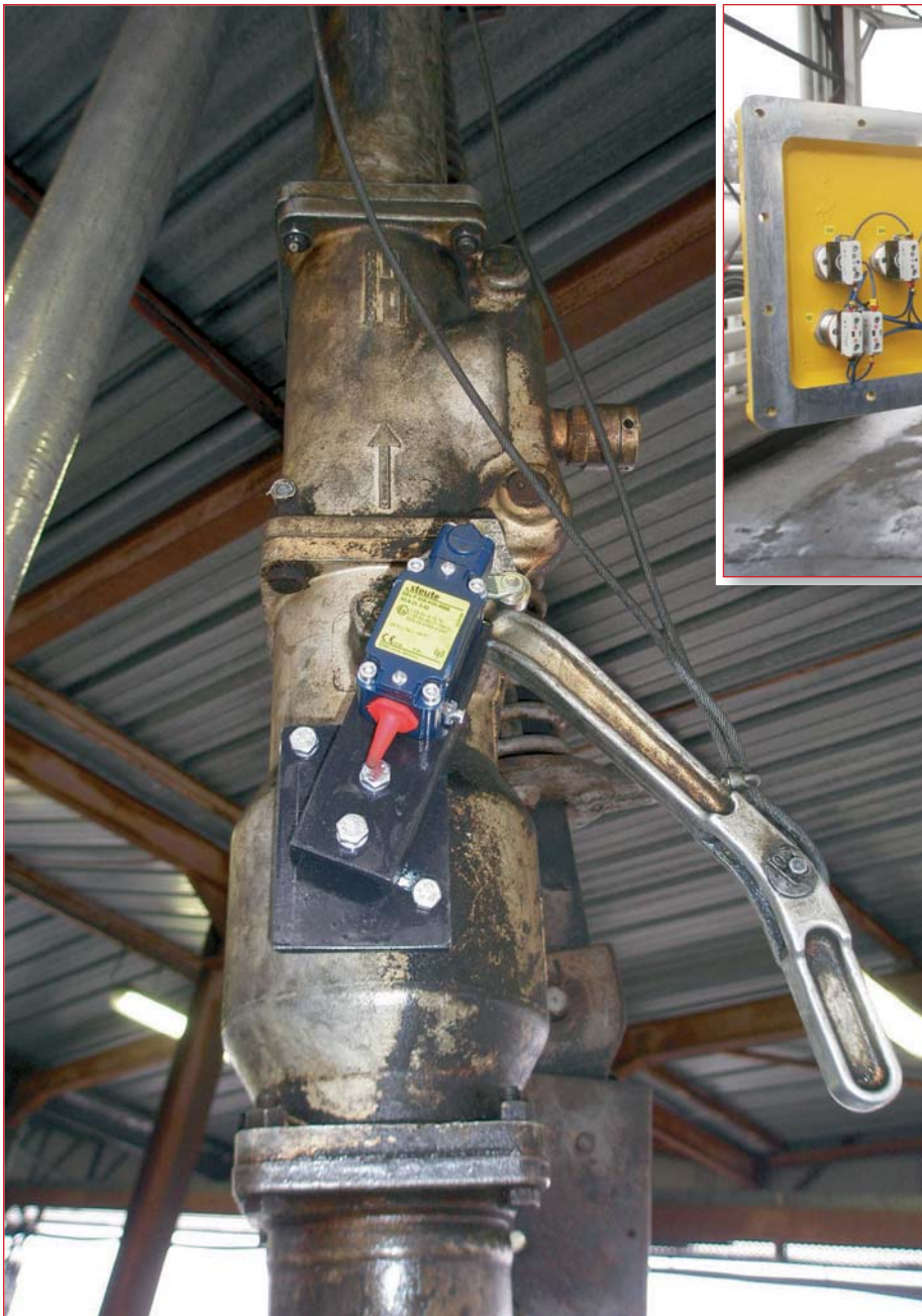
Die Stellung des Ventils an den Verladearmen einer Raffinerie wird von Wireless-Ex-Positionsschaltern übertragen.
