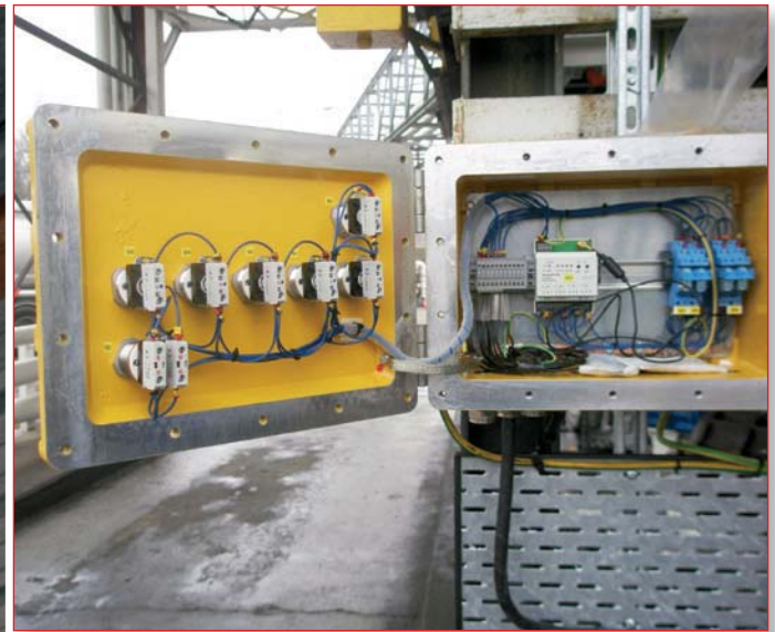
Die Empfangseinheit ist in einem Schaltschrank untergebracht. Im Freien können Reichweiten bis 300 Meter erzielt werden.
